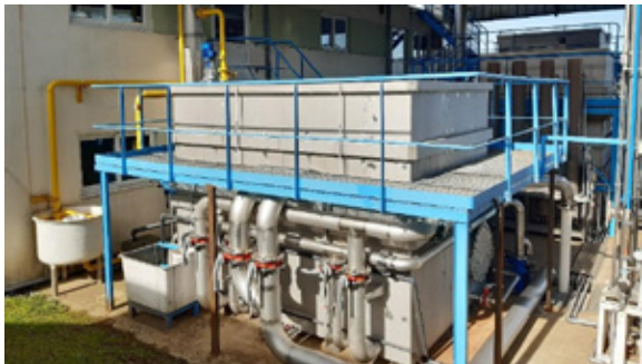
Nueva unidad compacta de potabilización de agua - Centro de formación de la OiEau - planta de La Souterraine. ©OiEau
